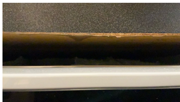
Svelling i benkeplate over oppvaskmaskin
