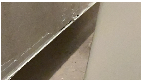
Søl av silikon, samt området som ikke er tettet
