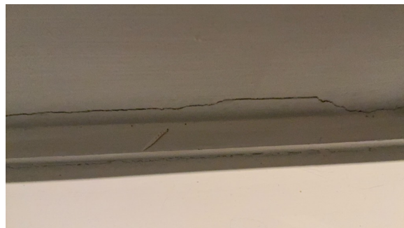
Sprekker i opptrinn
