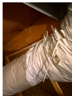
Flass av plastfolien på ventilasjonskanalen.
