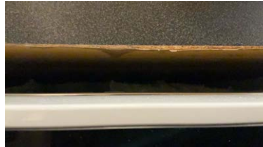
Svelling i benkeplate over oppvaskmaskin
