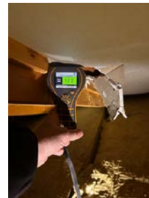
Det er registrert skade i gipsplaten. Fuktmåling med pigger viste ingen indikasjoner på forhøyet fuktighet.
