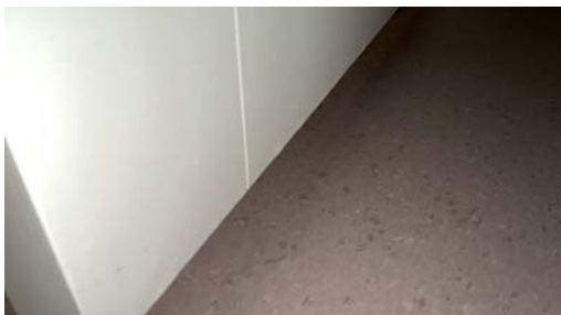
Fuktskjolder i bunn av badedør
