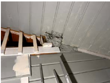
Overflater som ikke er ferdige i bod
