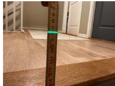
Høyde ved dørterskel 13,2cm
