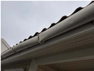
Takrennen ved inngangspartiet er bulket og skadet.
