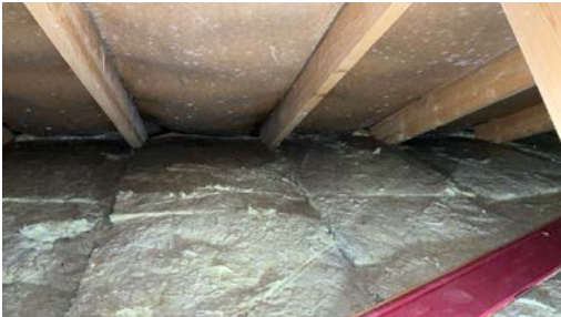
Lite lufting nede ved gesims, samt at ndertaket er misfarget.
