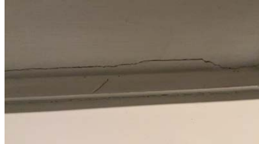
Sprekker i opptrinn
