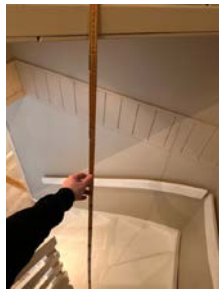
Lav frihøyde på mellom 1,8 og 1,9m
