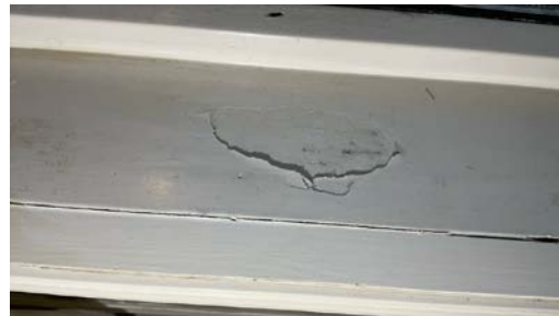
Malingsflass i vindusforing stue
