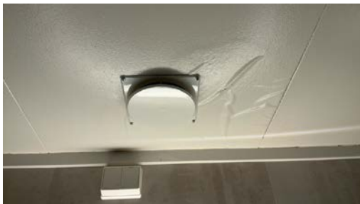
Løs folie på takplaten rundt ventil
