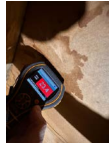
Registrert fukt i skjolder på undertak under pipe
