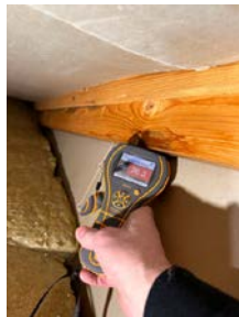
Registrert fukt i takstol mot nabo
