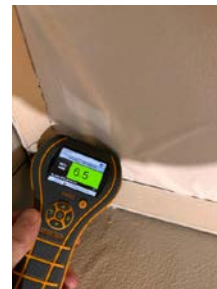
Takfolie som slipper på største soverom, ingen fuktantydning ved fuktmåling
