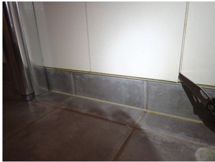
Skade i baderomsplate.
