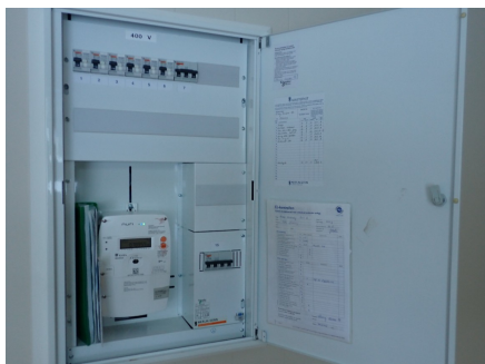
Sikringsskap med automatsikringer og automatisk strømmåler.
