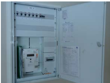
Sikringsskap med automatsikringer og automatisk strømmåler.
