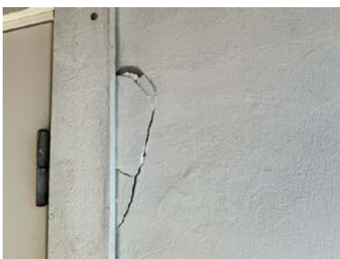
Sprekk ved dør, lokal utbedring anbefales.
