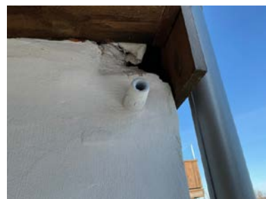
Hull mot kledningen bør fikses.
