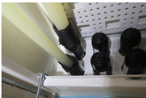
Bilde viser at varerør ikke er ført inn i fordelerskap på bad
