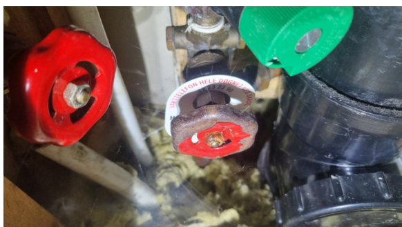
Hovedstoppekran av eldre dato uten kuleventil.
