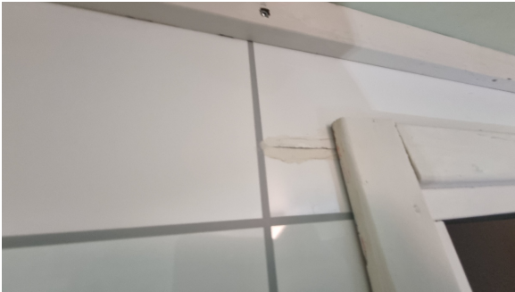
Liten skade på baderomsplate.
