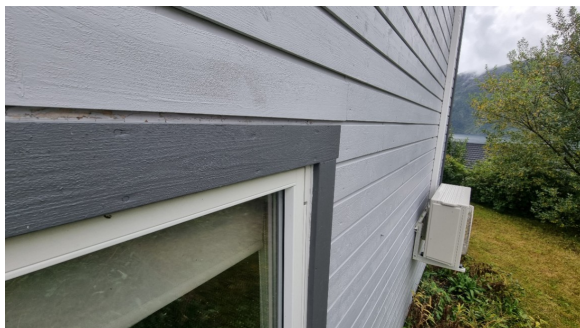
Det mangler beslag over vinduet
