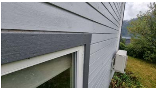
Det mangler beslag over vinduet
