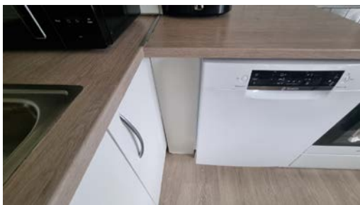
Noe ufagmessig utførelse av foring mellom oppvaskmaskin og skap.
