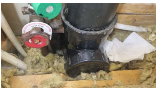
Avløpsrør av plast
