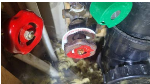
Hovedstoppekran av eldre dato uten kuleventil.
