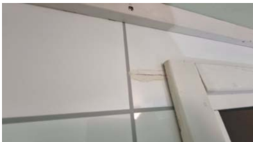
Liten skade på baderomsplate.
