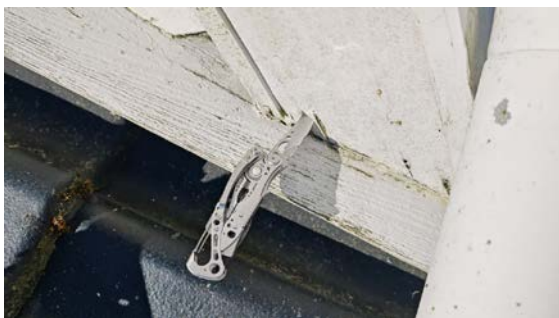
Det er ved stikktaking funnet mindre råteskade ved vegg på takopplett.
