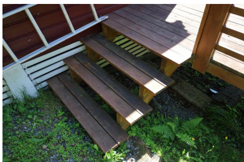
Trapp uten rekkverk. Fare for fall.
