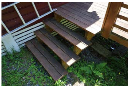
Trapp uten rekkverk. Fare for fall.
