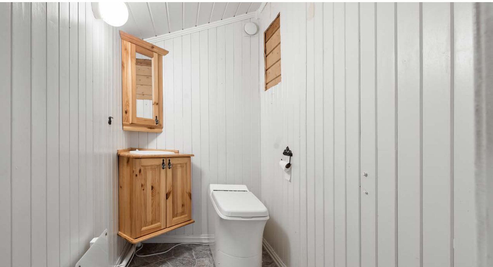
Sanitærom inredet med skap med vask og forbrenningstolett.
