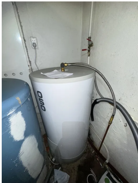
Viser bereder plassert i bod.
