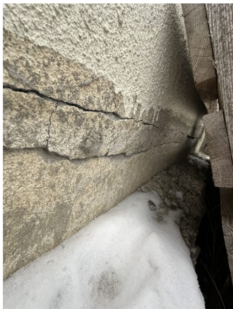
Grunnmuren har skader/sprekker.
