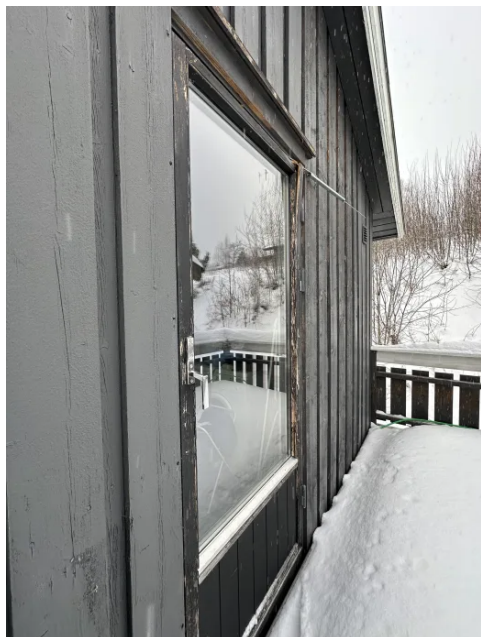
Det registreres skader på terrassedør ved vaskerom.
