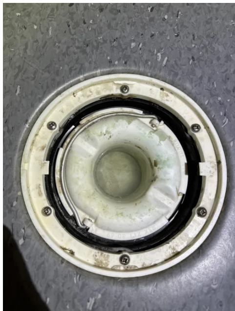
Viser sluk i dusjsonen.
