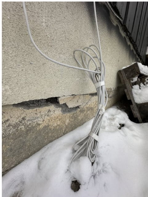
Grunnmuren har skader/sprekker.
