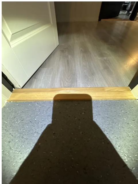
Manglende oppbrett av gulvbelegg ved dørterskel.
