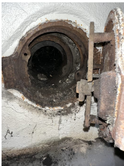
Det registreres rust på sotluke.
