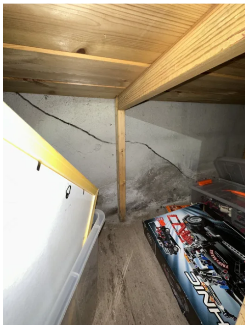
Grunnmuren har skader/sprekker.
