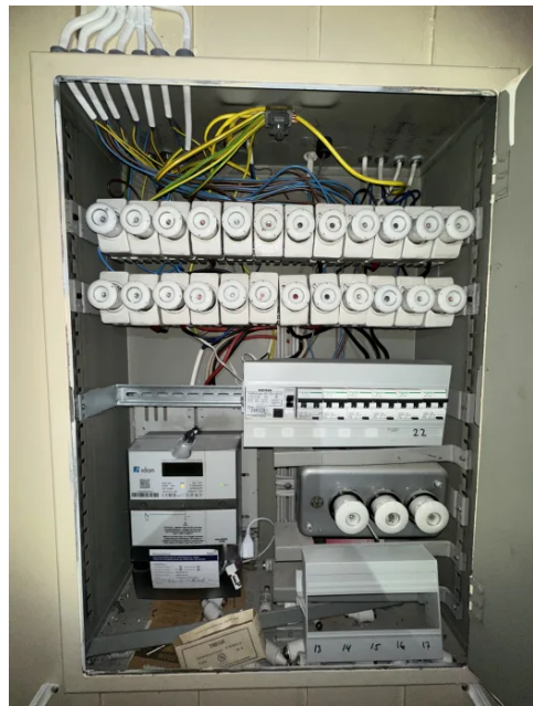
Viser sikringsskap plassert i gang.
