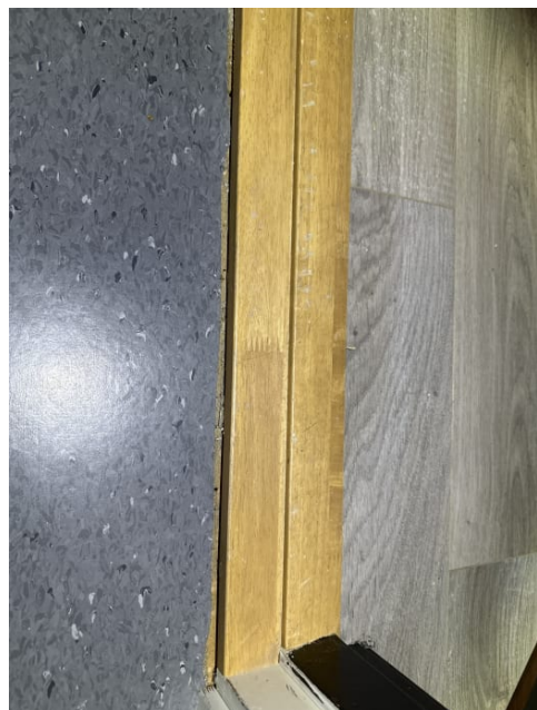
Manglende oppbrett av belegg ved terskel.
