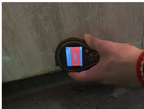
Undersøkelsen viser indikasjoner på fukt.
