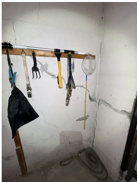
Grunnmuren har skader/sprekker.
