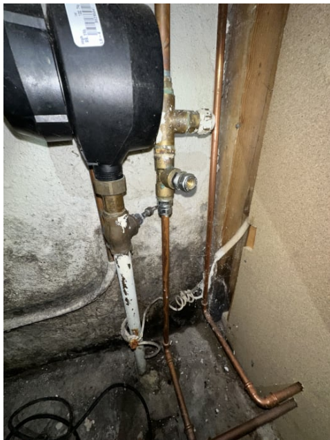
Viser vanninntak, hovedstoppekran og vannmåler.
