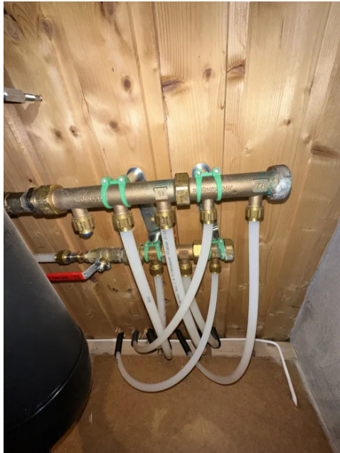
Viser åpen rørfordeler plassert i tak.
