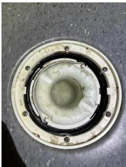
Viser sluk i dusjsonen.
