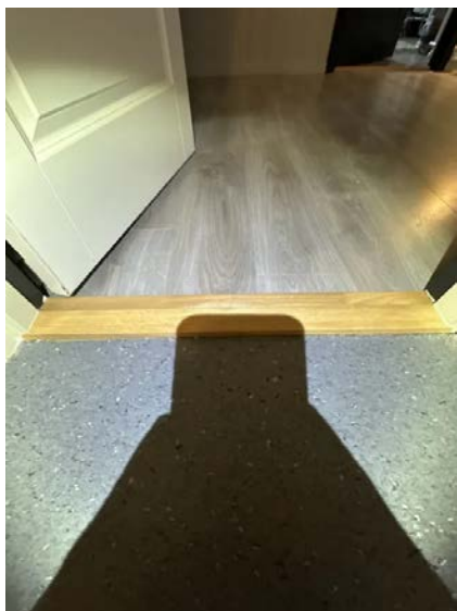
Manglende oppbrett av gulvbelegg ved dørterskel.
