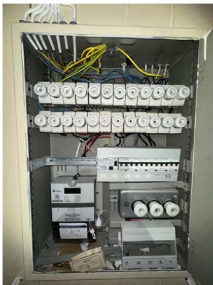
Viser sikringsskap plassert i gang.
