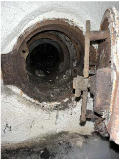
Det registreres rust på sotluke.
