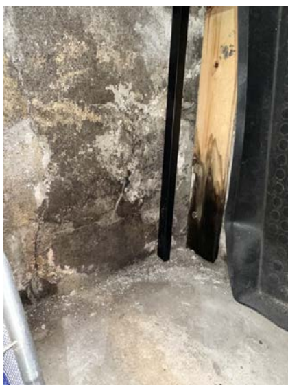
Det registreres sopp-/råteskader på innredning i tre ved innvendige grunnmurer.
