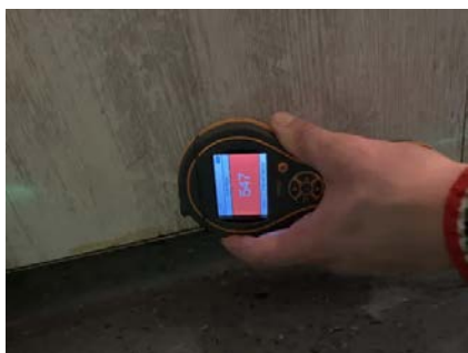
Undersøkelsen viser indikasjoner på fukt.
