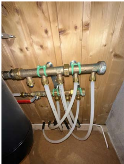
Viser åpen rørfordeler plassert i tak.
