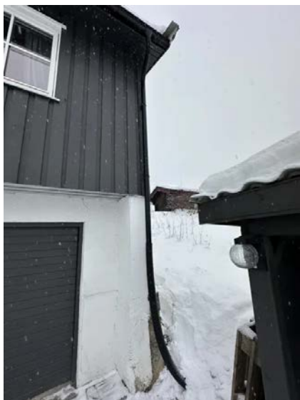
Enkelte nedløpsrør med drensør montert på utkast.
