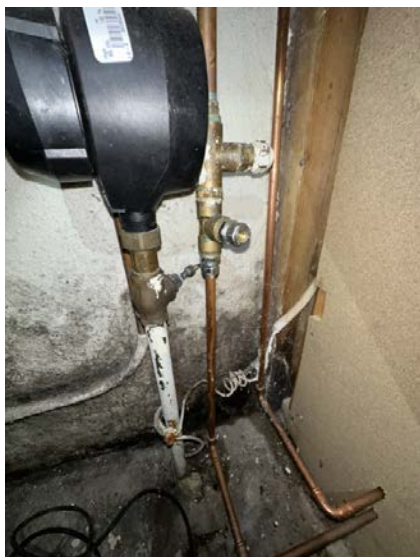
Viser vanninntak, hovedstoppekrane og vannmåler.
