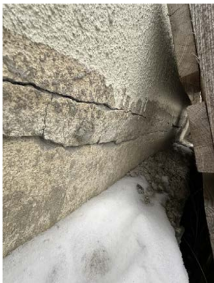
Grunnmuren har skader/sprekker.
