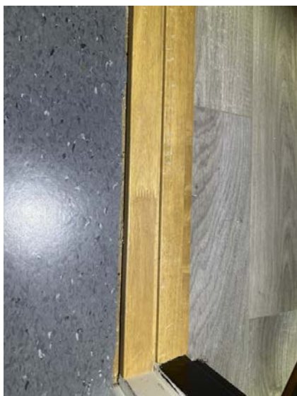
Manglende oppbrett av belegg ved terskel.
