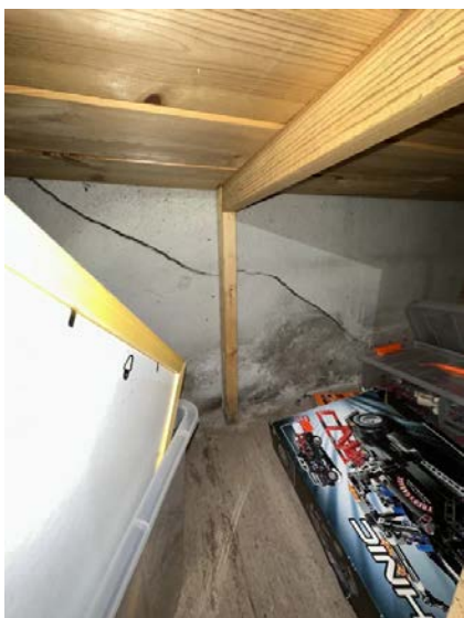
Grunnmuren har skader/sprekker.
