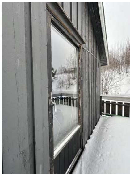
Det registreres skader på terrassedør ved vaskerom.
