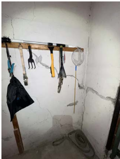
Grunnmuren har skader/sprekker.
