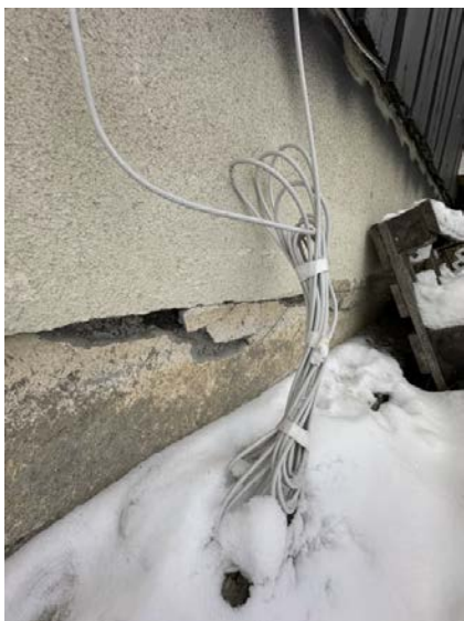
Grunnmuren har skader/sprekker.
