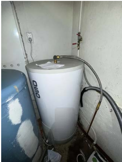
Viser bereder plassert i bod.
