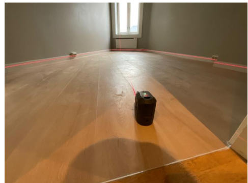
Nivellering soverom, avvik ca. 10-20 mm
