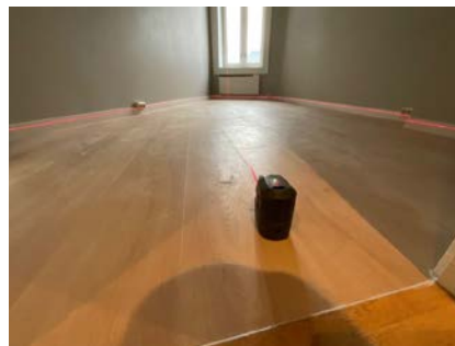
Nivellering soverom, avvik ca. 10-20 mm
