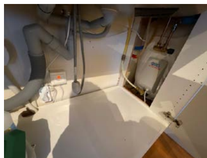
Varmtvannstank i benkeskap
