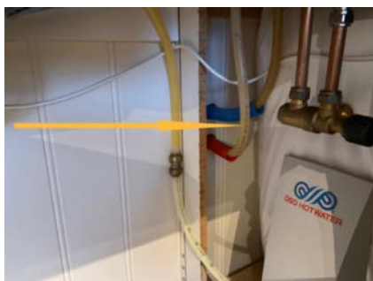
Rør i rør uten tetting
