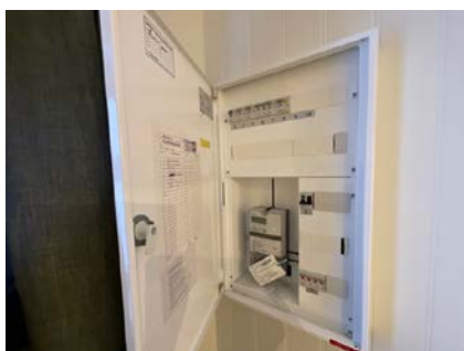
Sikringsskap på soverom
