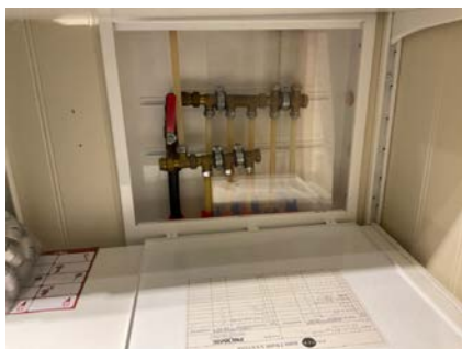
Rør i rør skap i boden
