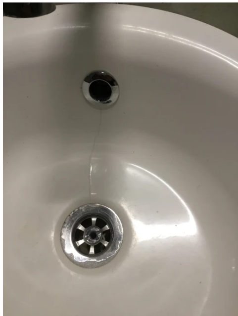
Synlig riss i servanten.
