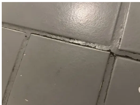
Stedvis riss i fuger på gulvflis.
