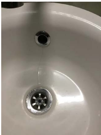
Synlig riss i servanten.
