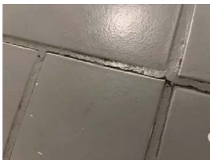
Stedvis riss i fuger på gulvflis.
