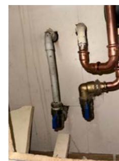
Stoppekraner plassert i kjøkken
