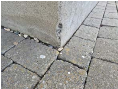
Løs puss på hjørne og synlig lecablokk.
