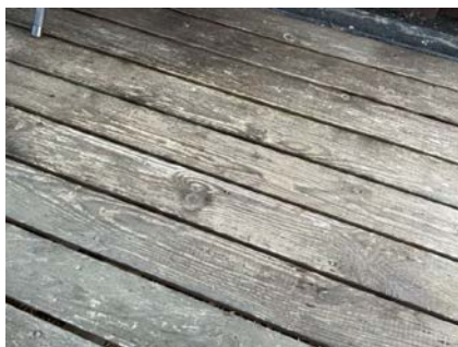
Slitasje og vedlikeholdsbehov
