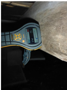
Høyt fuktinnhold i bærebjelke.
