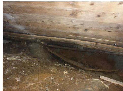
Råte i stubbloftsbord som delvis falt ned.
