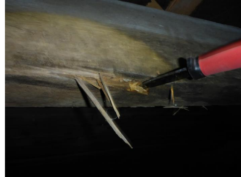
Råte i bærebjelke.
