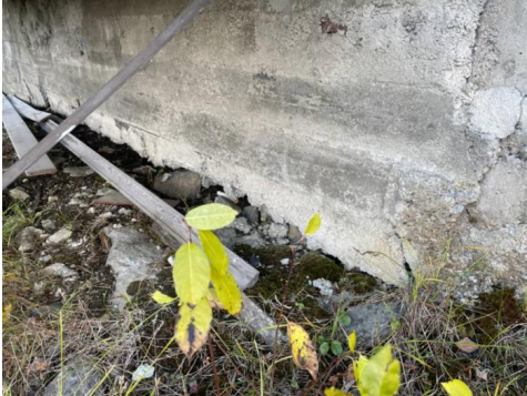
Synlig åpning under grunnmur
