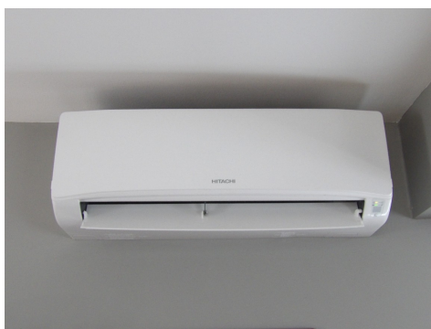
Varmepumpe i stue.
