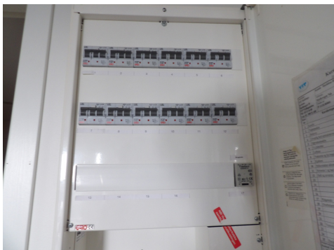
Sikringsskap i entrè.
