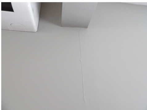
Noe sprekke på vegger.
