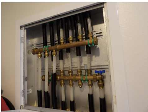
Rør i rør sentral på vaskerom.
