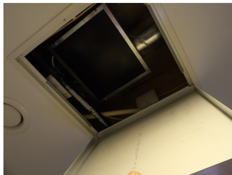
Motor for ventilasjon i luke i himling på vaskerom.
