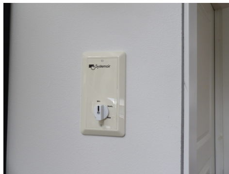
Styringspanel for ventilasjon på vegg i stue.
