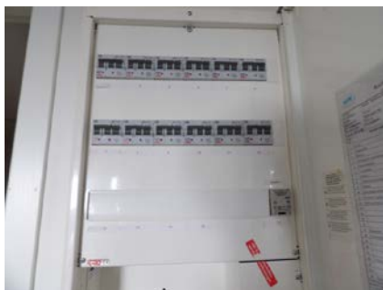
Sikringsskap i entrè.
