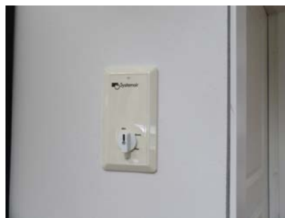
Styringspanel for ventilasjon på vegg i stue.
