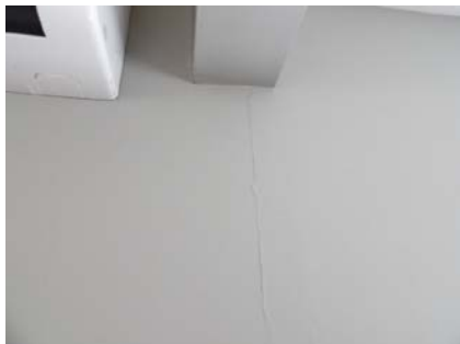
Noe sprekk på vegger.
