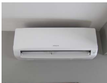
Varmepumpe i stue.
