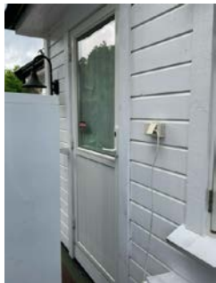
Balkongdør fra vindfang til vaskerom.
