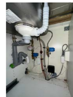
Rørpropplegg i kjøkkenbenk med Waterguard
