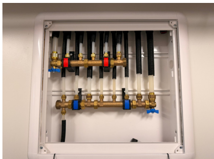
Vannskap på vaskerom.
