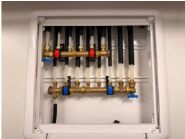
Vannskap på vaskerom.
