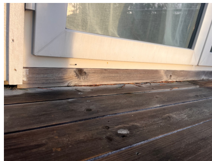
Mangler beslag under dør.
