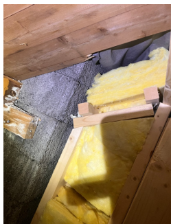
Undertak ikke tilfredsstillende montert
