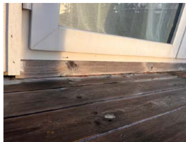
Mangler beslag under dør.
