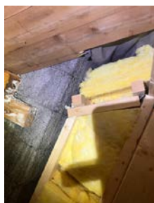
Undertak ikke tilfredsstillende montert
