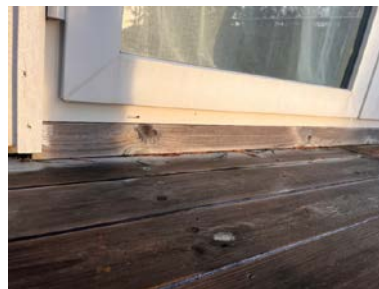
Mangler beslag under dør.
