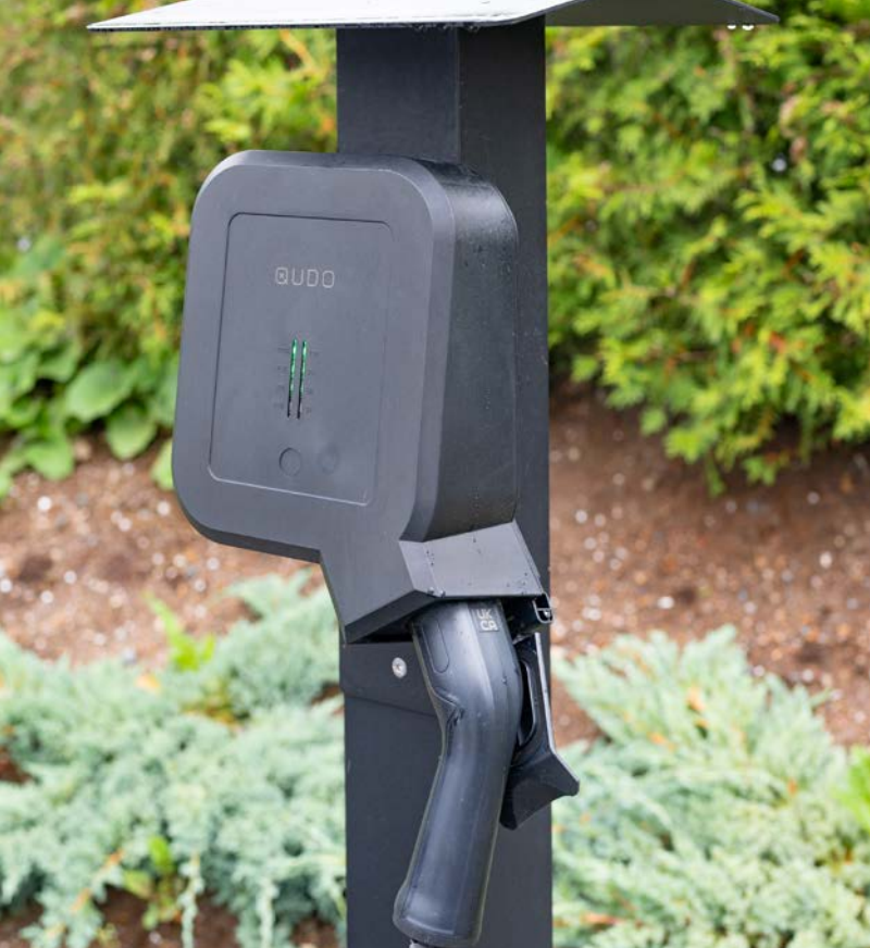
Denne leiligheten har installert egen el-bil lader som går på denne leilighetens strømforbruk.
