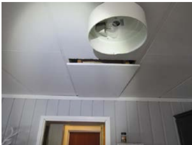
Manglende låsing av loftsluke
