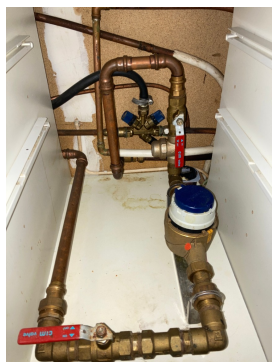
Vannmåler/stoppekrane i skap under vask i leilighet
