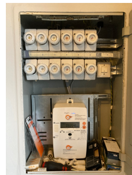
Sikringskap til underetasje (leilighet)
