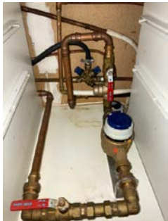
Vannmåler/stoppekrane i skap under vask i leilighet
