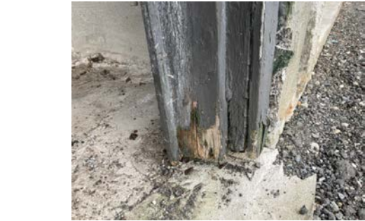
Skade karm, port til garasje
