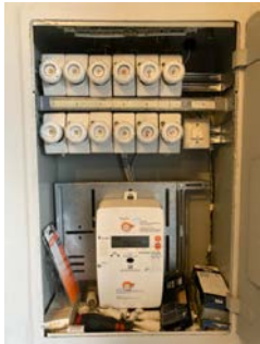
Sikringskap til underetasje (leilighet)
