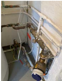
Vannmåler/stoppekrane i bod, til hoveddel
