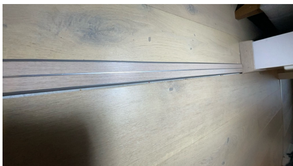
Glippe list gulv mellom entre og stue/kjøkken.
