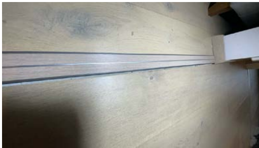
Glippe list gulv mellom entre og stue/kjøkken.
