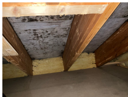
Muggvekst på undertaket.
