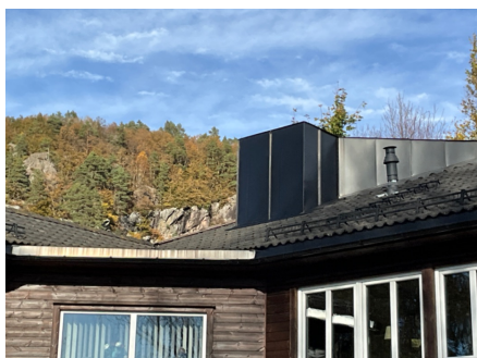
Utettheter på taket.
