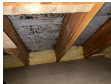
Muggvekst på undertaket.
