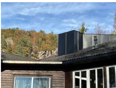
Utettheter på taket.
