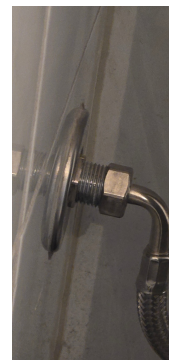
rørgjennomføring for stort, hull i flis er tettet med silikon
