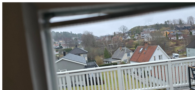
Løs list mellom isolerglass
