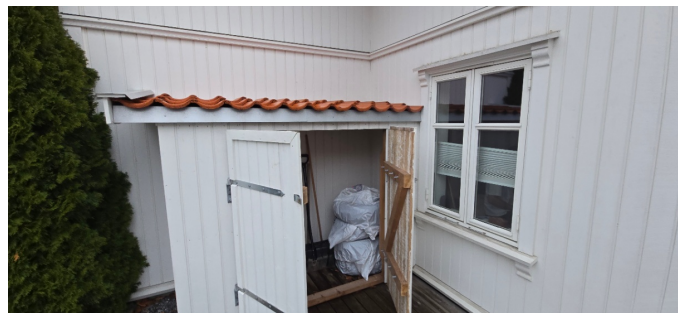
Bod inngangsparti mangler beslag inn mot vegg, takrenner. For lav takvinkel for takstein
