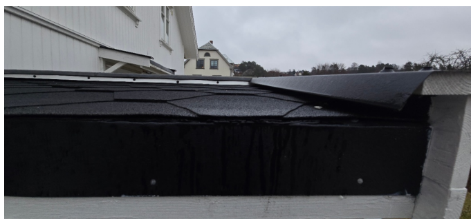
Bod på terrasse mangler takrenner og for lav takvinkel.
