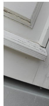
Terrassedør flask og sprekker i nedkant
