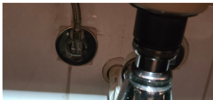
Rørgjennomføringer i servantskap har ikke synlig membran eller mansjett
