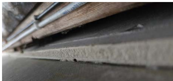
Nedre kant av kledningen har begrenset lufting, og det er ikke synlig muse-sikring.
