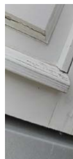
Terrassedør flass og sprekker i nedkant
