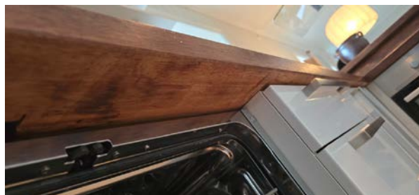
ikke fukt sikring under benkeplate ved oppvask maskin
