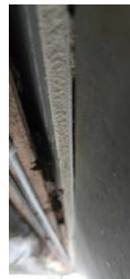
Nedre kant av kledningen har begrenset lufting, og det er ikke synlig muse-sikring.
