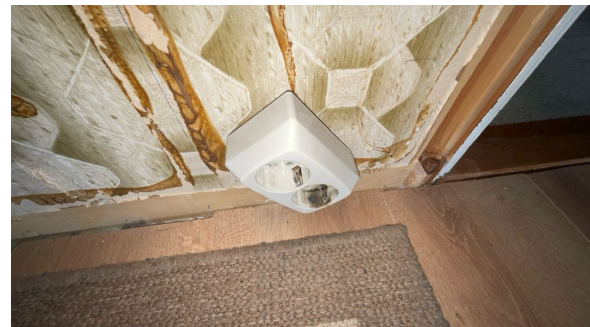
Løs stikkontakt på stue. Tegn på varmgang i stikkontakt
