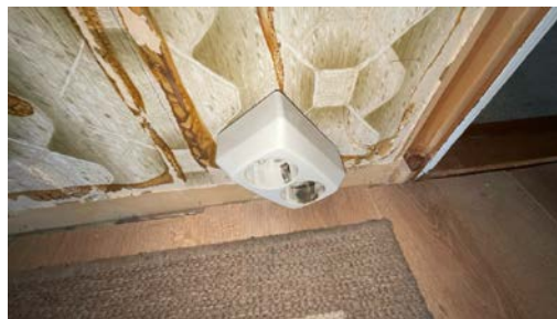
Løs stikkontakt på stue. Tegn på varmgang i stikkontakt
