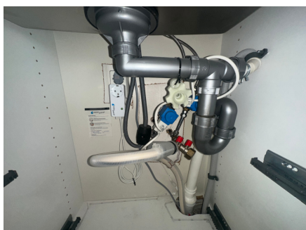
Røropplegg i kjøkkenbenk med Waterguard
