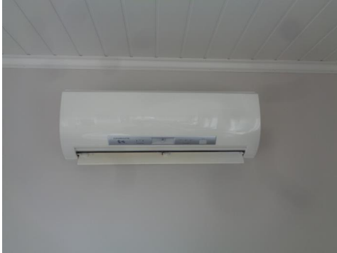
Varmepumpe i stue.
