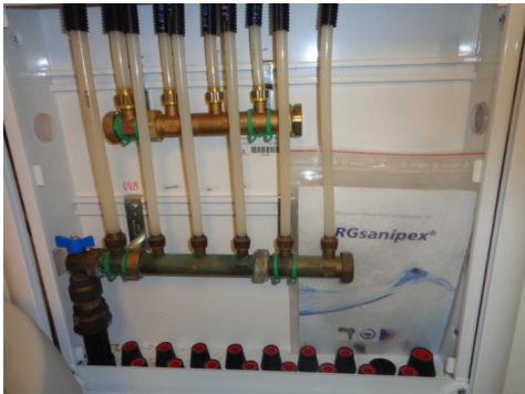
Rør i rør sentral.
