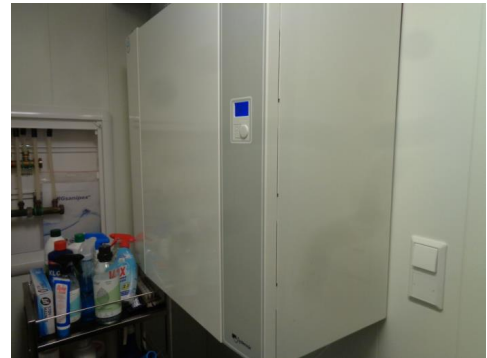
Balansert ventilasjonsanlegg i utleiedel.
