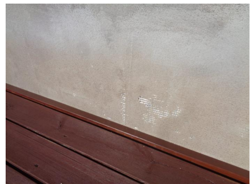
Noe synlig hønsenettet gjennom puss.
