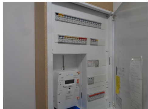
Sikringsskap i teknisk rom.
