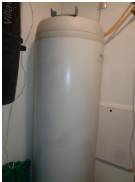
Varmtvannsbereder i teknisk rom.
