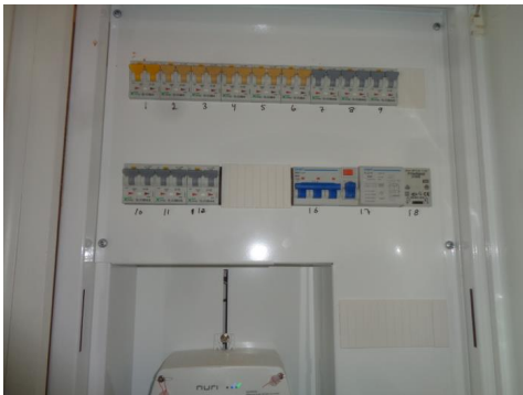
Sikringskap i entrè.
