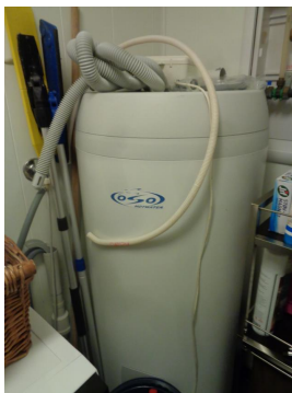
Varmtvannsbereder i teknisk rom utleidel.
