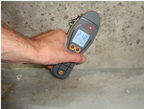
Noe forhøyet fuktverdier på betongvegg mot terreng på lager.
