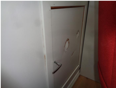
Skade på dør til knevegg.
