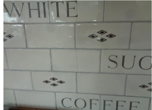
Sprekk i flis på vegg.
