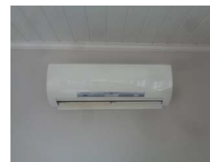
Varmepumpe i stue.
