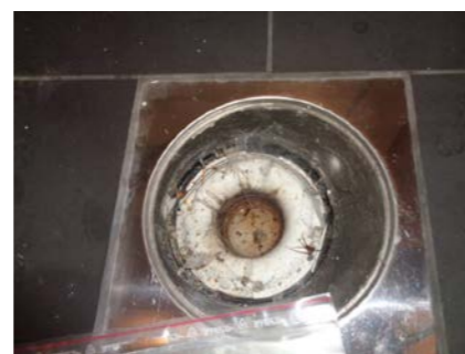
Plastsluk i teknisk rom.
