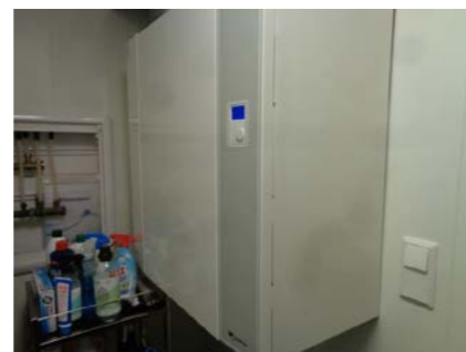
Balansert ventilasjonsanlegg i utleiedel.
