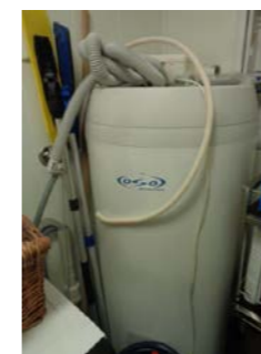
Varmtvannsbereider i teknisk rom utleiedel.
