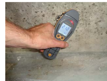
Noe forhøyet fuktverdier på betongvegg mot terreng på lager.
