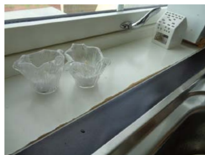
Dårlige overgang mellom benkeplater og foringer til vindu på kjøkken.
