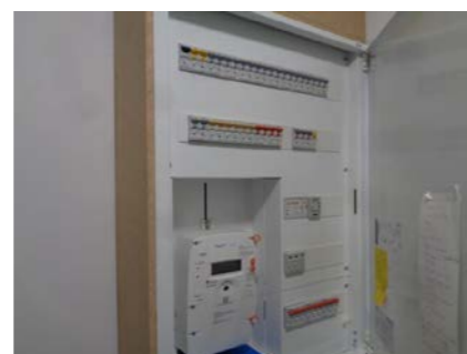
Sikringsskap i teknisk rom.
