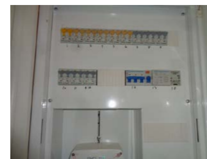
Sikringsskap i entré.
