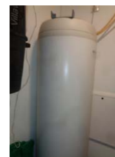
Varmtvannsbereider i teknisk rom.
