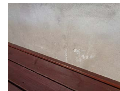
Noe synlig hønsenettet gjennom puss.
