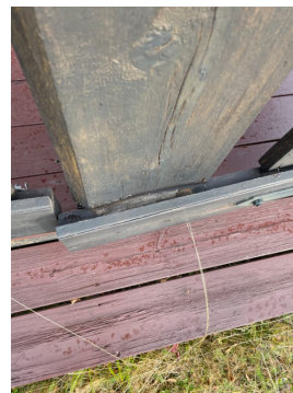
Stedvis løst konstruksjonsvirke
