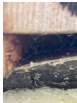
Manglende lusing og liten lufting bak kledning.
