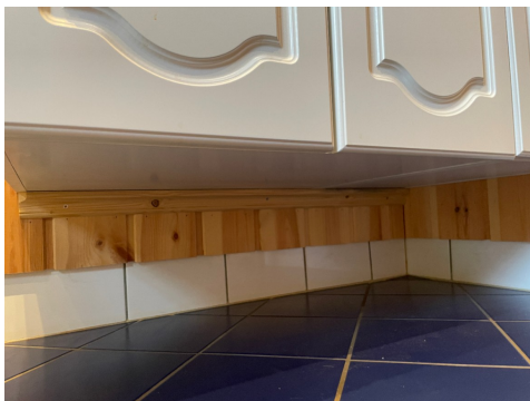
Misfarging/svertesopp underkant innredning.
