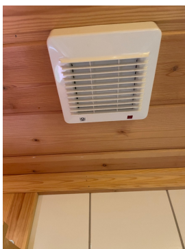
Avtrekksvifte fungerte ikke ved test.
