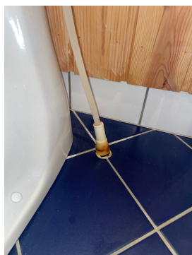
Rørgjennomføring mangler tettesjikt.
