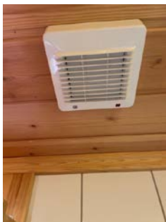
Avtrekksvifte fungerte ikke ved test.
