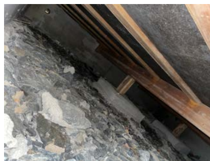
Muggsopp på overflater til stubbeloft
