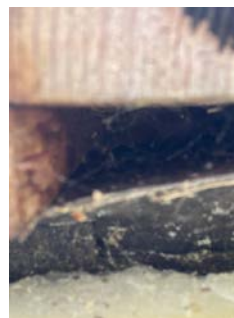
Manglende lusing og liten lufting bak kledning.
