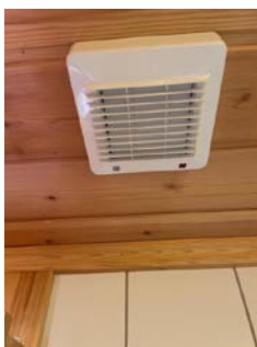
Avtrekksvifte fungerte ikke ved test.
