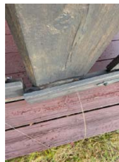
Stedvis løst konstruksjonsvirke
