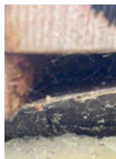
Manglende lusing og liten lufting bak kledning.
