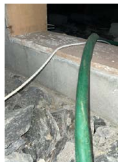
Muggsopp på treverk i åpning.
