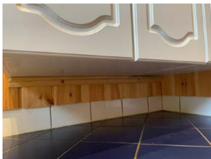
Misfarging/svertesopp underkant innredning.
