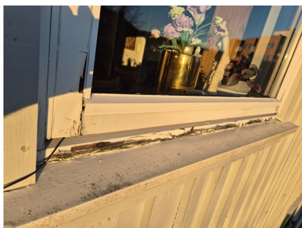
Utvendig værslitt vindu.
