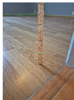
Skjevheter på gulv i soverom 2.
